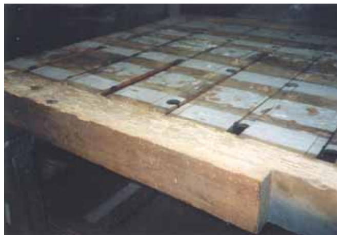
Schleifen-Ebene (Rahmen vom Holzwurm zerfressen)
